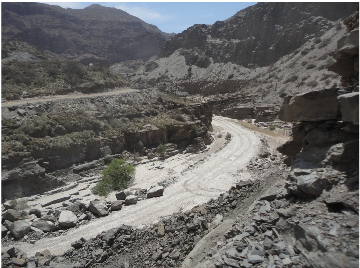
Formations de roches sédimentaires extrêmement fracturées le long du canyon de l'Agua de la Peña
